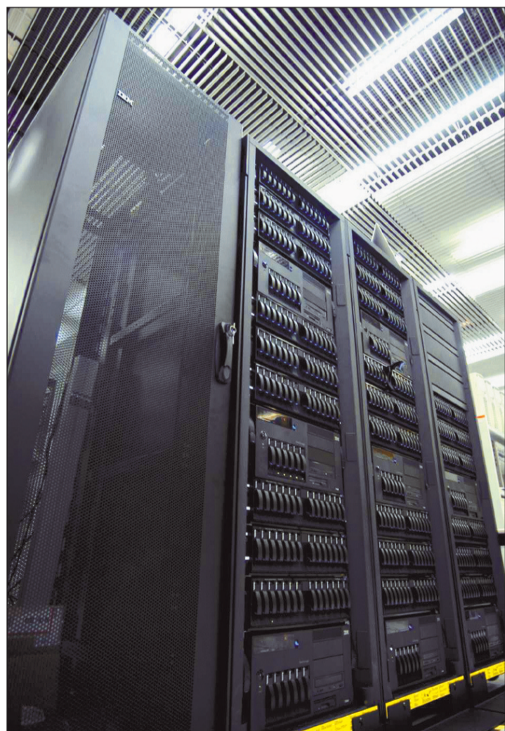
Le «Storage Tank» développé par IBM mettra sous pression à 10 gigabit/seconde le réseau ultrarapide du CERN. Si l'expérience est concluante, elle sera étendue...
